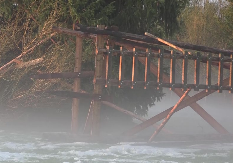
Sturmschaden © Dominik Bartl
