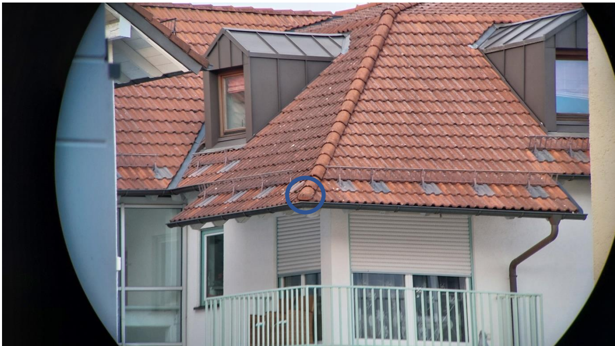
Abbildung 12: Brutplatz eines Mauerseglers unter einem Dachziegel. Solche Strukturen dürften vermehrt energetischen Sanierungen zum Opfer fallen. Sie lassen sich durch entsprechende Kästen relativ leicht ersetzen.
