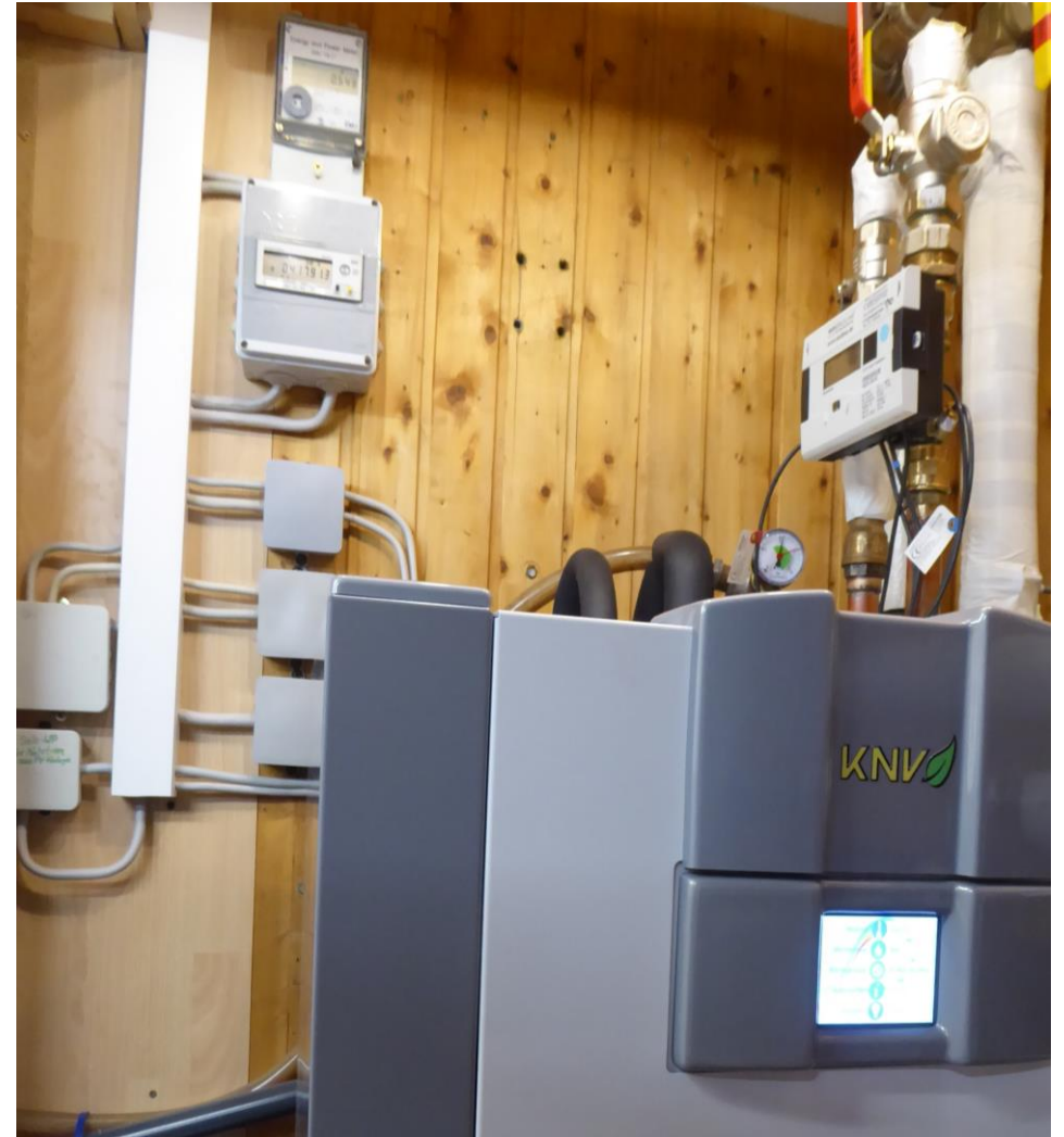
Luft-Wasser-WP 12 KW / 3 kW mit vielen Messmöglichkeiten für Info und Kontrolle
