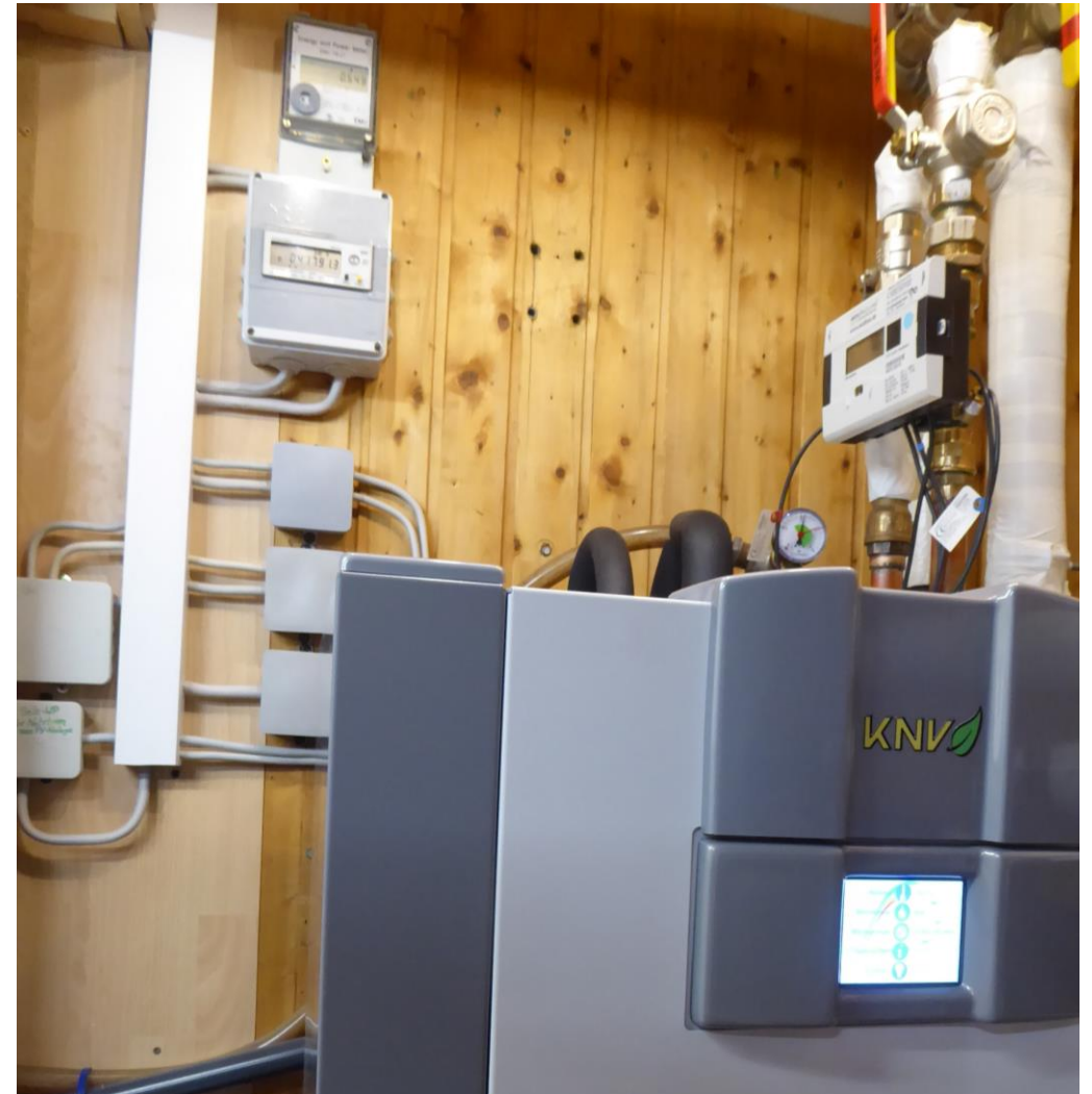
Luft-Wasser-WP 12 KW / 3 kW mit vielen Messmöglichkeiten im Hause Kirchensteiner
