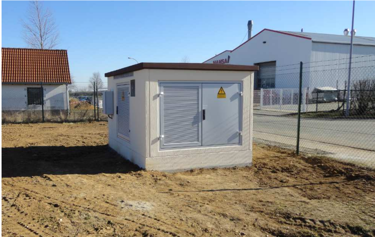
Abbildung 9: Ansichtsbild Trafostation, Quelle: VISPIRON EPC GmbH, München
