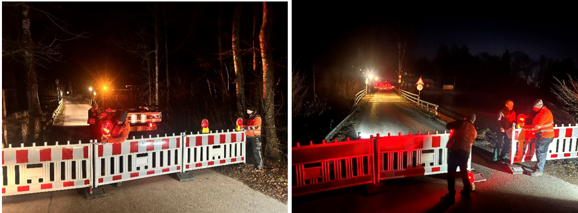
Mitarbeiter des städtischen Bauhofs haben spätabends noch die Vollsperrung des Dammes zwischen Kirnbergersee ( „Huberer Weiher“) und „Kleiner Weiher“ eingerichtet. Fotos: tka / Stadt Penzberg
